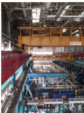
Pannocell à 40 m.
