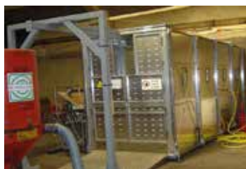
Manutention des déchets dans les sas.
