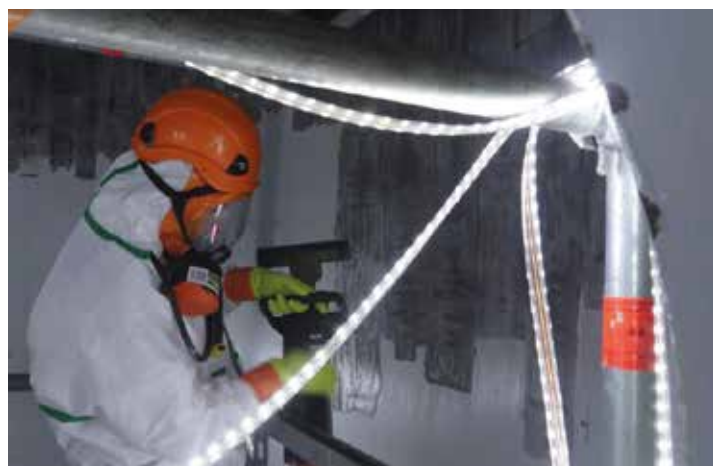
Habilitation nucléaire. Zone contrôlée.
