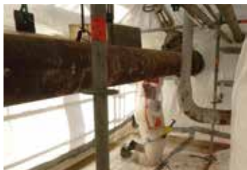
Tuyauterie chaude >100°C.
