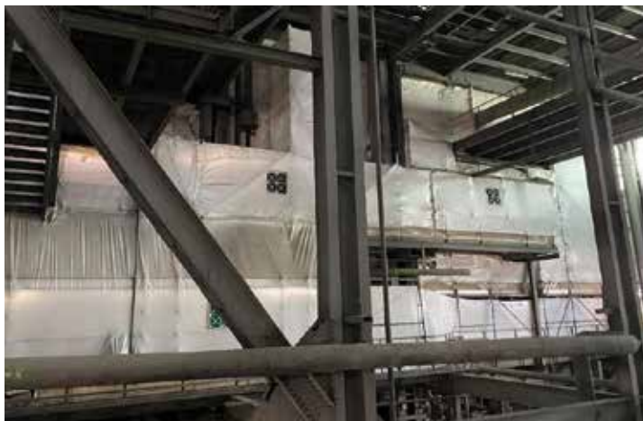
Traversées de charpente et tuyauteries, chemins de câbles, ...
