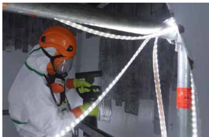
Habilitation nucléaire. Zone contrôlée.
