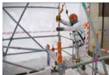
Moyens de manutention des déchets en zone.
