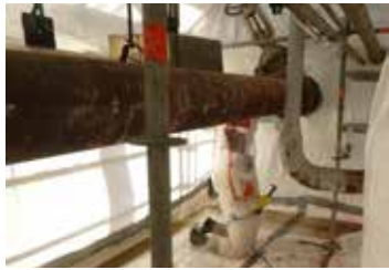
Tuyauterie chaude >100°C.
