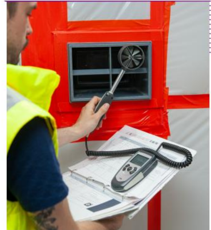
Mesure d'air au niveau d'une entrée d'air
